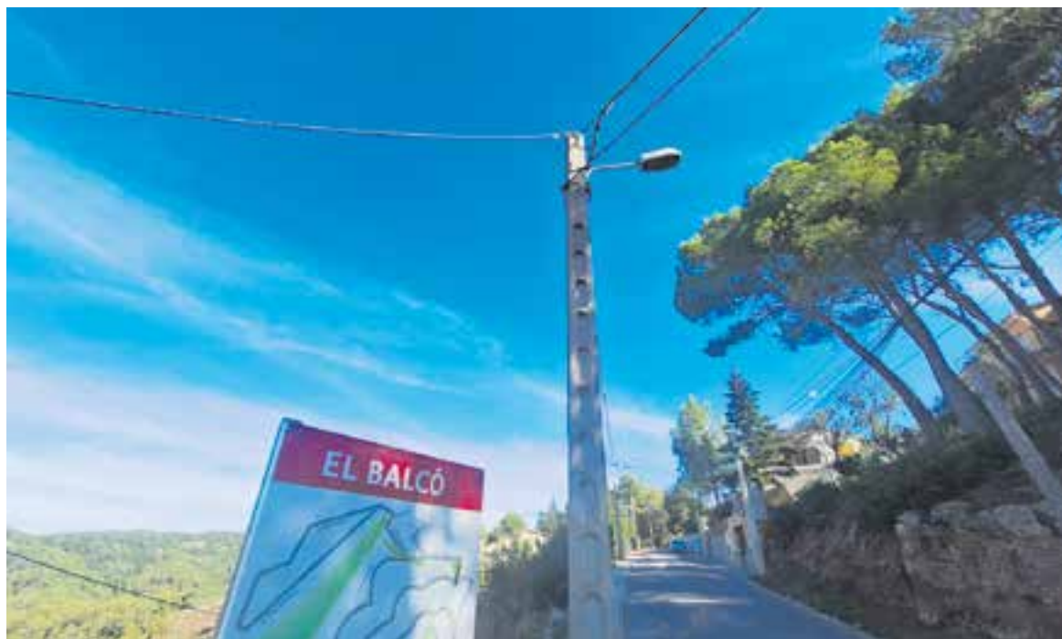
Cablejat elèctric de mitja tensió al carrer Comagrossa, a El Balcó, una de les xarxes que es milloraran. || A.J. CASTELLAR
