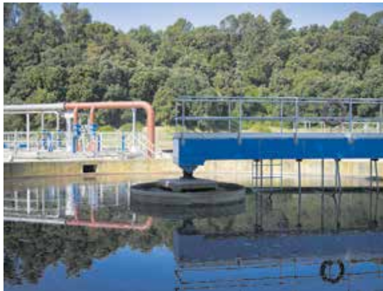
Imatge de la depuradora de Castellar. || Q. PASCUAL
