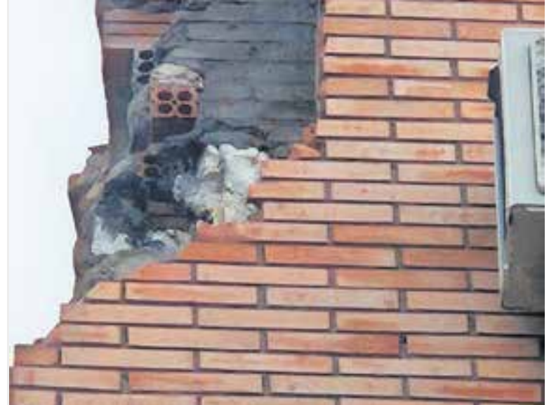
Així van quedar la façana i la cornisa del pis afectat. || BOMBERS || @ANTIRADARCATALA
